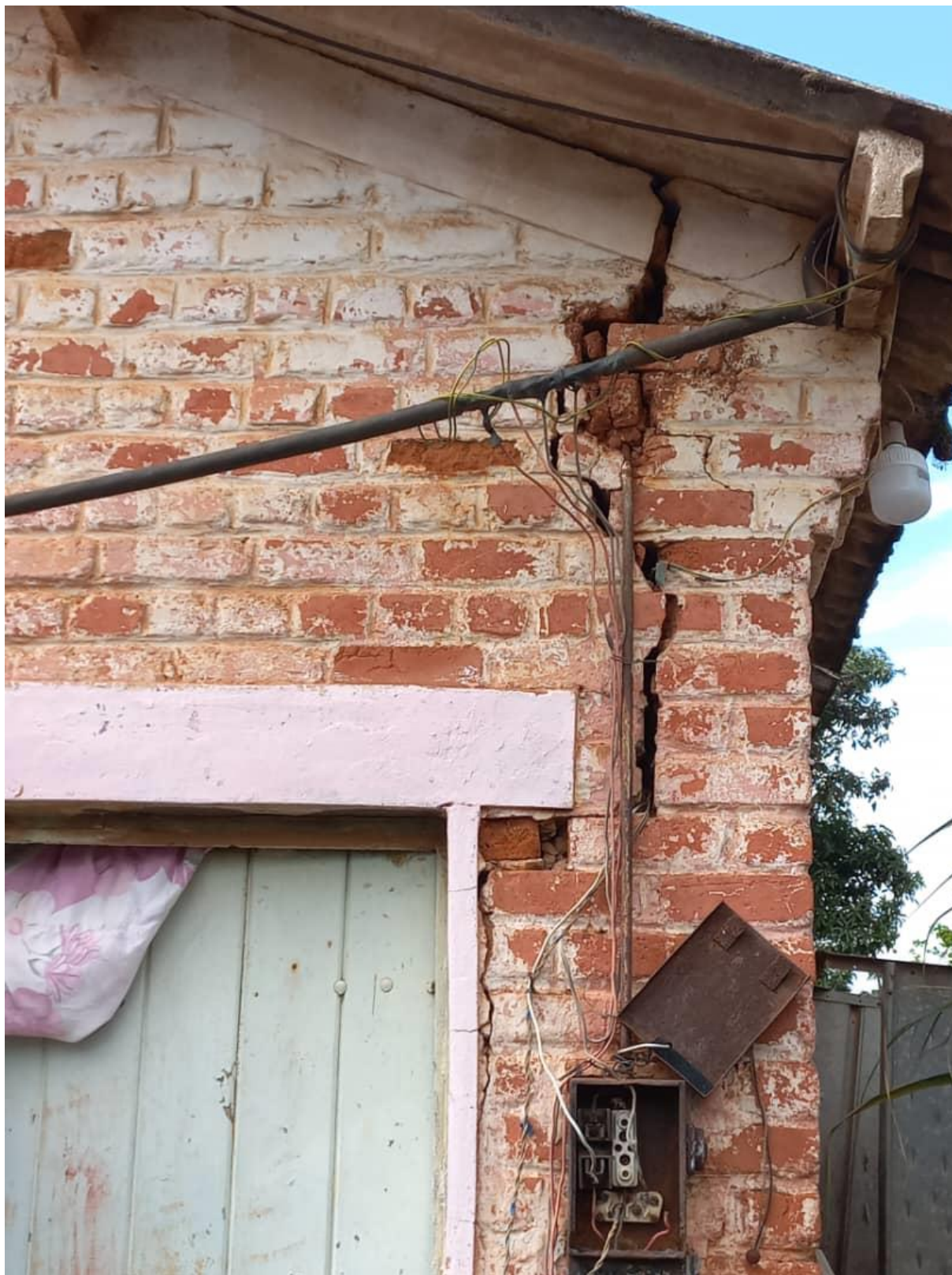
Figure III.20.impact sur les bâtiments
